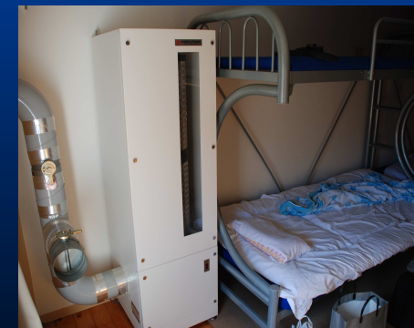
避難施設に設置されている脱硫装置
